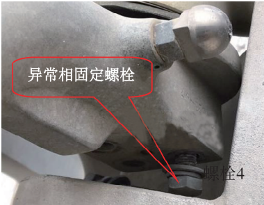
(b) C 相未掉落的螺栓
